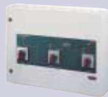
Külső szerviz bypass-panel
